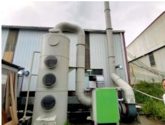
项目废气处理设施现状
