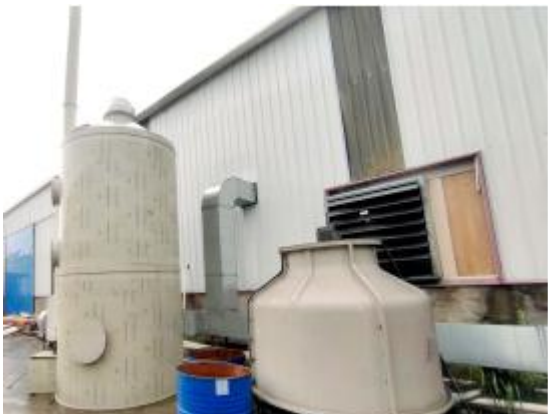
项目废气处理设施现状
