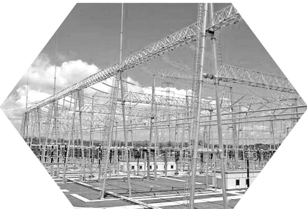
▲500千伏敬州变电站。
