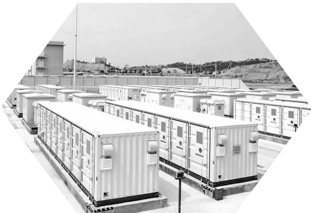
▲全球首个浸没式液冷储能电站在五华县投入运行。
