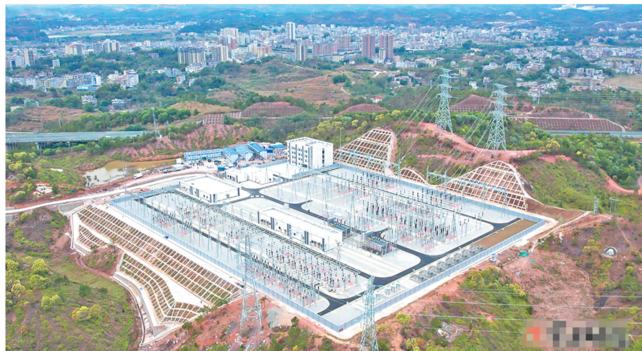
220千伏双安变电站。
